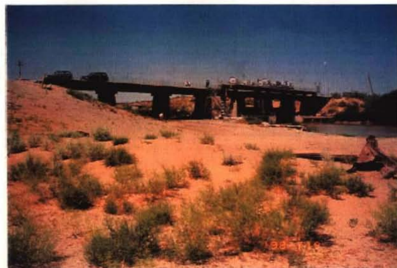
Structure 326 チェックゲート
