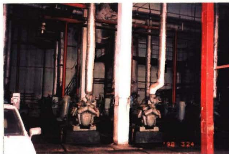
ビシュケーク市内保冷倉庫冷却装置
