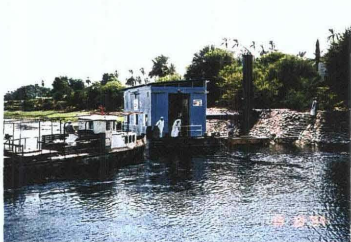
フローティングポンプ側面部（無償実施）
