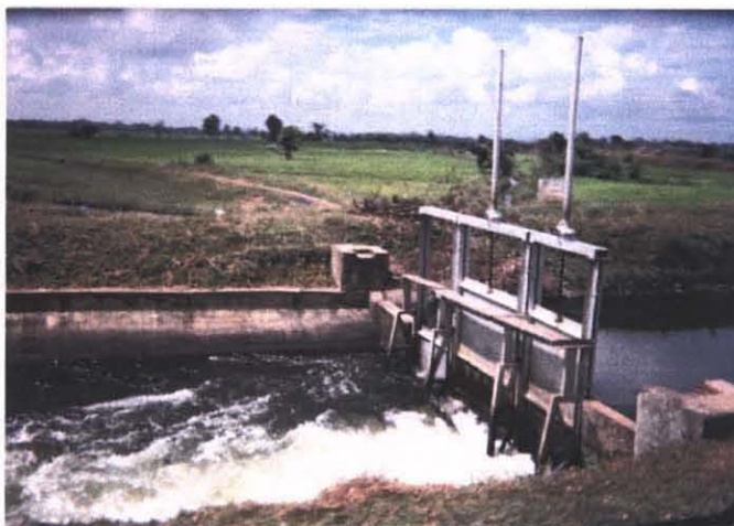
幹線水路水位調節ゲート
