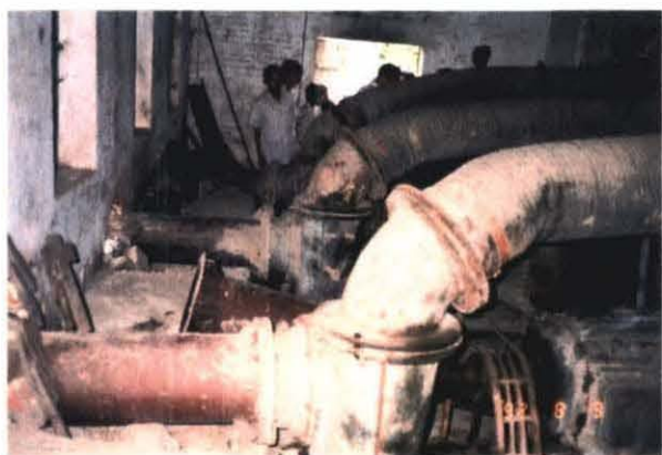
ニンビン県 Khah Hoa 村の用・排水ポンプ場 廃墟かと思ったら稼動していた
