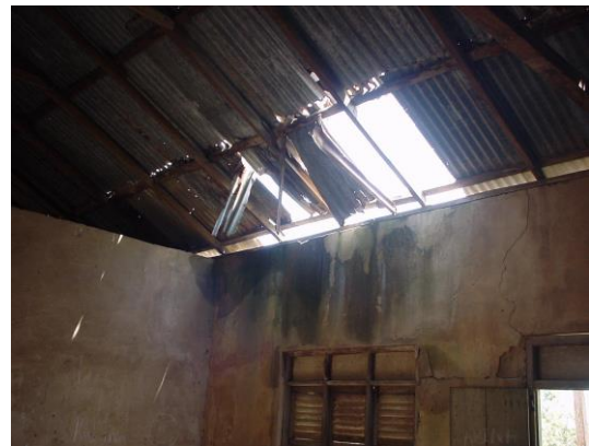
教室の屋根の破損状況
