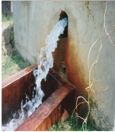
ポンプ場から吐き出される水
