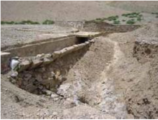
水路の破損状況
