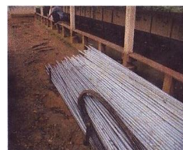
支援されたパイプ
