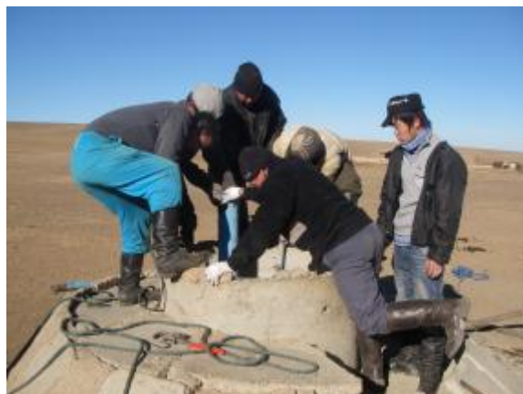
修理を要する井戸
