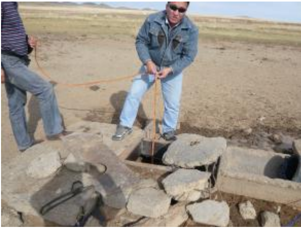
修理を要する井戸（現在はロープによる手汲み）
