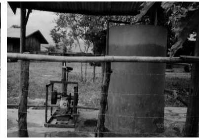
支援金で設置した井戸とポンプ
