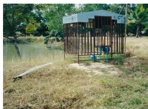
水源地とポンプ施設
