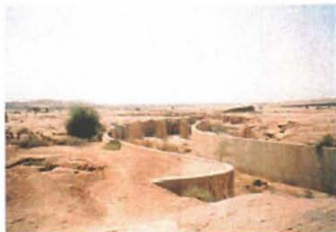
Bolan ダム計画の幹線水路始点 (損傷して使用されていない)
