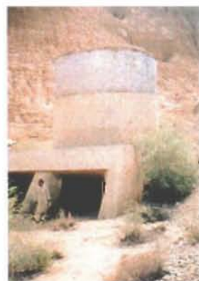
Bolan ダム計画の取水施設 (損傷して使用されていない)
